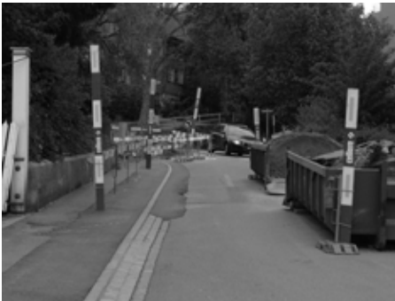
Vorbildliche Abschränkung an der Baustelle Ruhbergstrasse. Trotz wenig Platz ist der Weg für Fussgängerinnen und Fussgänger durchgehend geschützt.
